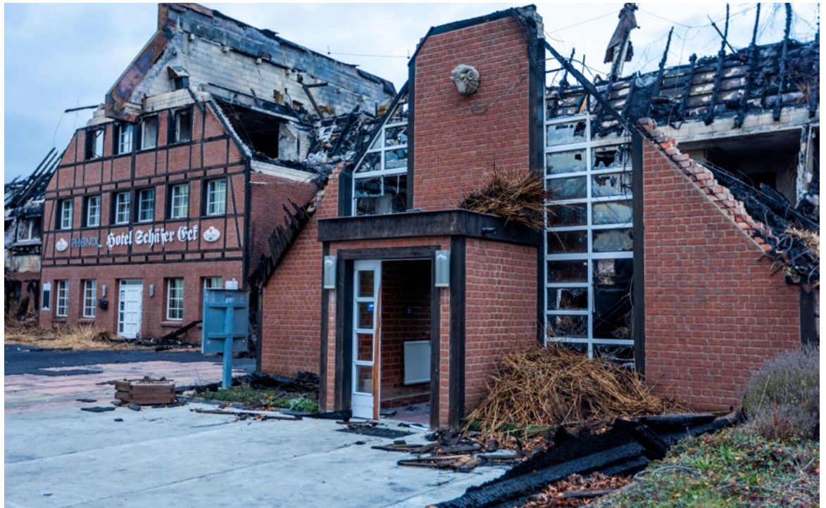
— Die Reste eines in der Nacht zum 20.10.2022 in Groß Strömkendorf komplett abgebrannten Hotelgebäudes, das als Unterkunft für Geflüchtete aus der Ukraine genutzt wurde.
